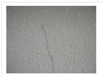
ヘアークラック（施工前）
